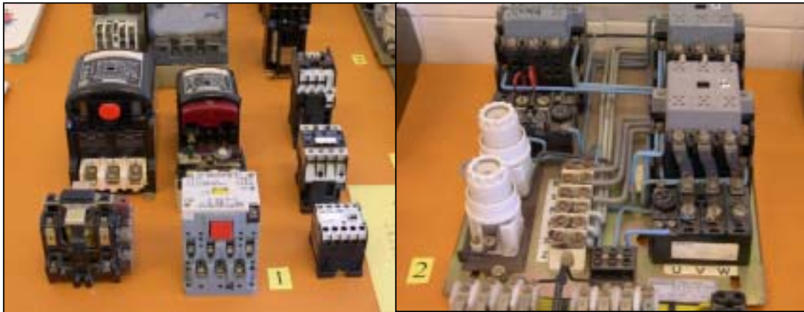
Contactores de varias épocas -- Cableado de automatismos utilizando hilo rígido
